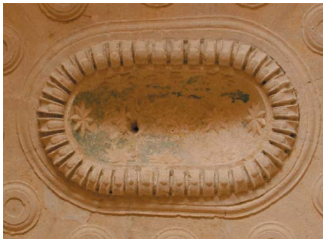
Bóveda celeste en la capilla Bautismal de la Iglesia Mayor Abacial. Vista general y detalle.
